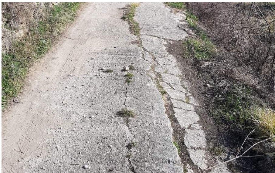
Slika 4. Pogled na deformirani dio postojećeg betonskog kolnika
